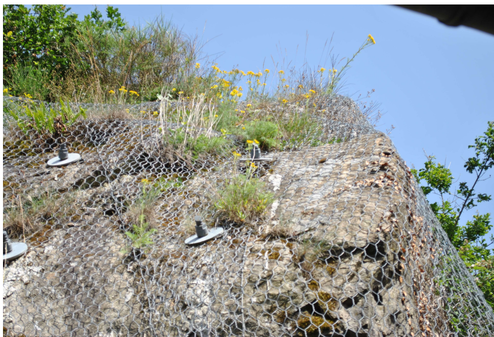
Dispositif d'ancrage avec filets métalliques sur la commune de Hérisson (Source : DDT 03)
